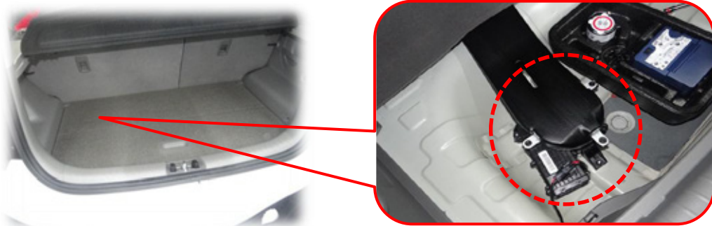
Lüfter der Hochvoltbatterie
